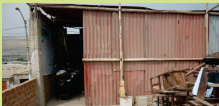
Precariedade das salas de aula
