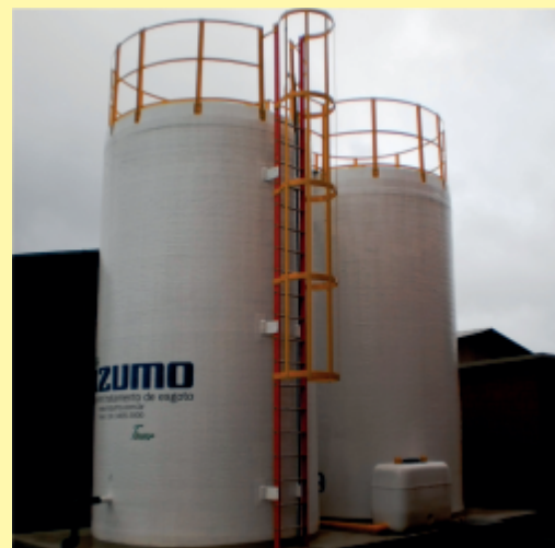
Tratamento de esgoto cloacal - 1
